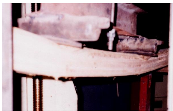
b) Kerusakan balok RBB.25
