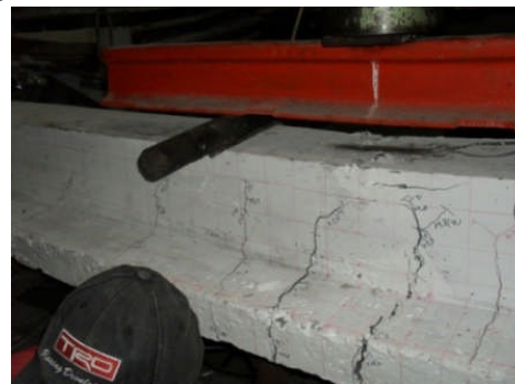
Gambar 11 Pola retak balok perkuatan tipe 1 (BP1).
