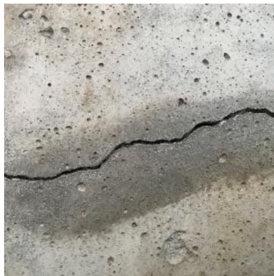
Gambar-1 Contoh Retakan Beton
