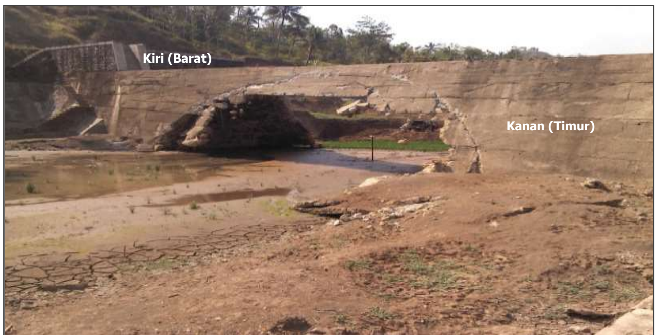
Gambar-3. Spillway pada BPS Kedung Ringin setelah jebol.
