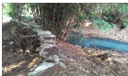
Gambar-8. Kondisi tanggul Kali Juana.
